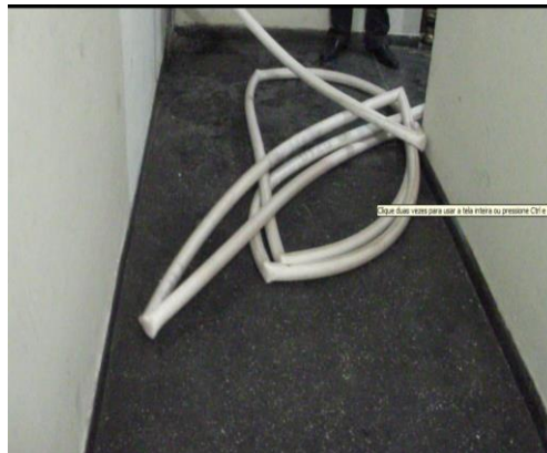
Foto 14 – Mangueira emaranhada após a pressurização sem o lançamento prévio
