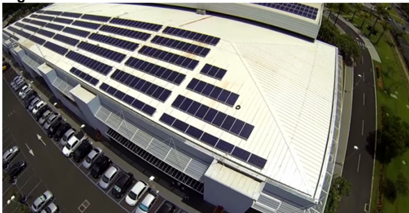
Figura 4 - Painéis fotovoltaicos instalados no telhado de um Data Center
