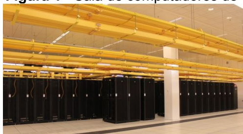
Figura 1 - Sala de computadores de um Data Center
