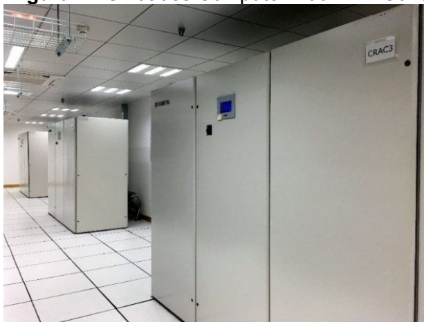
Figura 2 - Unidades Computer Room Air Conditioner (CRAC)
