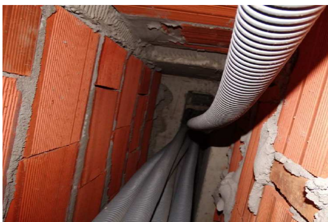
Figura 32: Ausência de compartimentação vertical entre os pavimentos.
