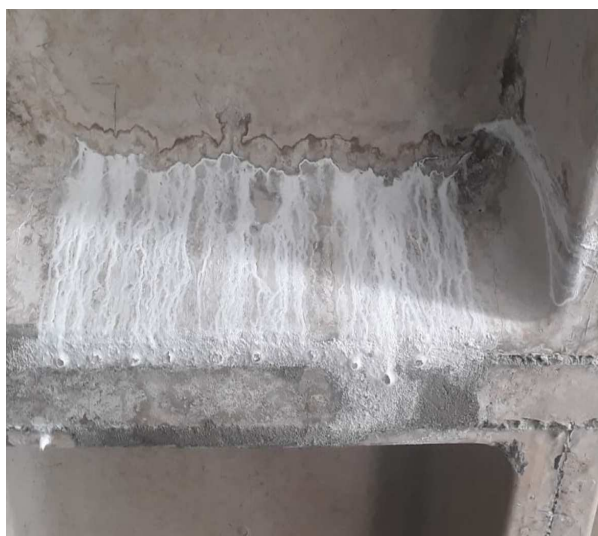
Figura 15: Lixiviação e eflorescência.
