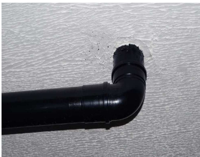
Figura 37: Instalação de curva 90° na prumada sem dispositivo de inspeção para limpeza.
