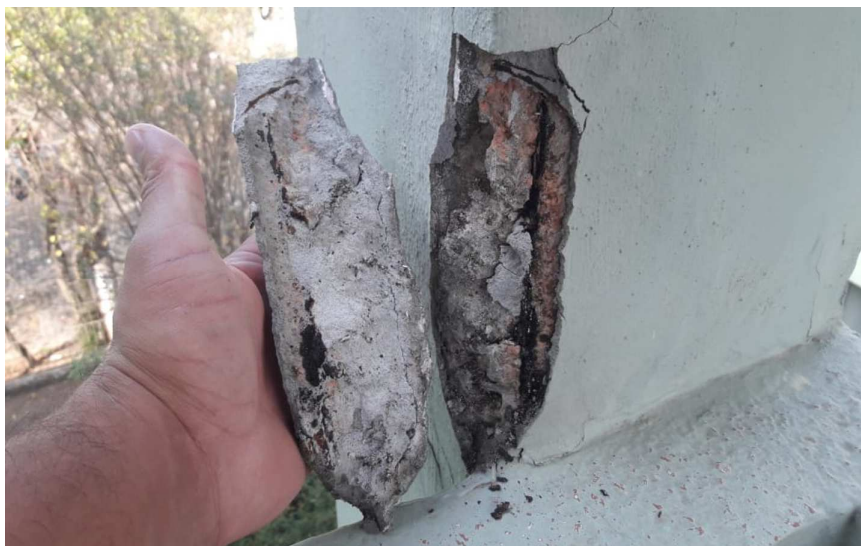
Figura 13: Estrutura de concreto armado carbonatada e armadura com corrosão.
