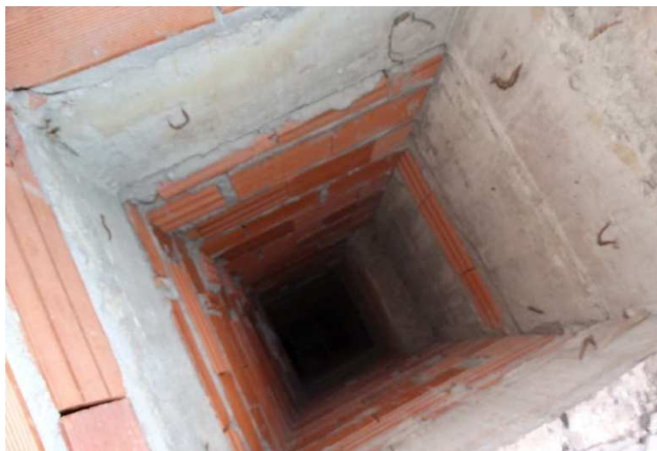
Figura 25: Poço de ventilação desprotegido contra queda.
