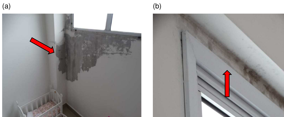
Figura 29: Deslocamento do gesso devido a Infiltração (a) e (b).
